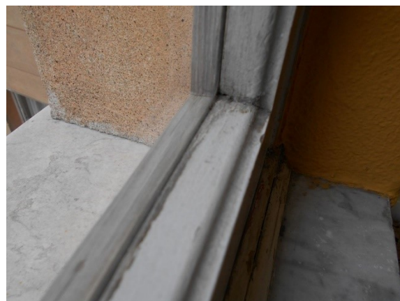
Figura 2.3 - Particolare dei serramenti in legno e vetro singolo – dettaglio angolo vetro
